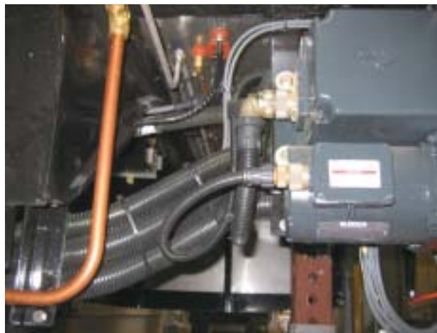
図1 銅管およびフレキシブル配管(シアトルLRV)
